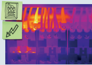
Tesislerin bakımı: Arızalar meydana gelmeden önce devre kesicilerdeki ve elektrikli bileşenlerdeki aşırı yüksek sıcaklıkları belirleyin.
