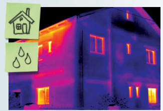
Binalardan kaynaklanan enerji kayıplarını tespit edin: Bina cephelerinde veya dış cephelerde termal köprüleri hemen tanımlayın ve kaydedin.
